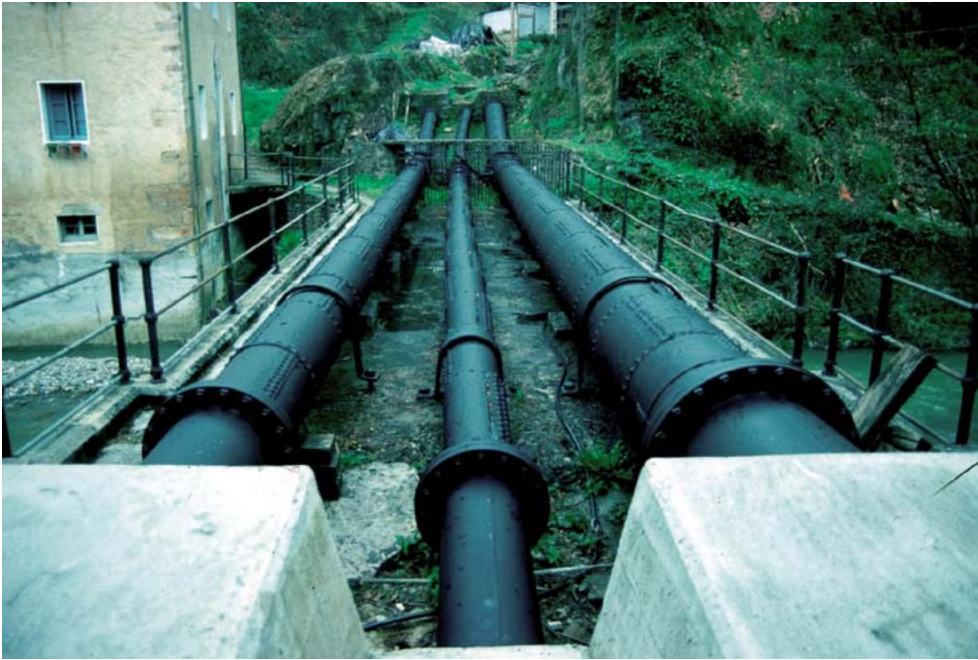
Olate zentralaren hiru ur-jauzietako karga-hodiak. (Kultura Saila. Eusko Jaurlaritzza) Detalle de las tuberías de carga de los tres saltos de agua de la Central de Olate. (Departamento de Cultura. Gobierno Vasco)
